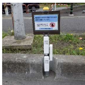
道路浸水センサ設置状況
