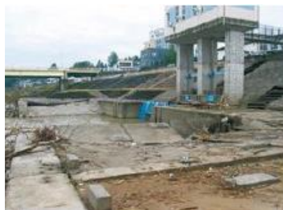
水門低水護岸の破損
