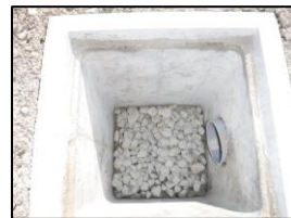
雨水貯留浸透枡整備事例（昭和町）
