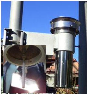
更新前の通風筒 中には温度計センサー
