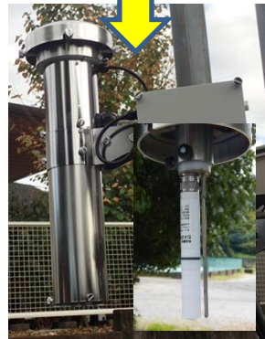
更新後の通風筒 中には温度計と湿度計の センサー
