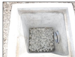
雨水貯留浸透枡整備事例(昭和町)
