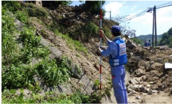
被災状況調査
