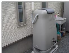
貯留槽の整備事例(富士市)
