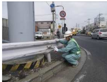
〈構造物の状況確認（防護柵損傷）〉
