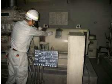
〈発電設備 定期点検状況〉
