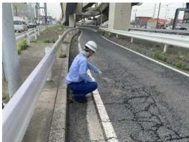
〈路面状況確認（ひび割れ発生）〉
