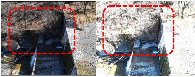
写真-3 黒潰れの事例（貉窟砂防堰堤） 画質調整なし(左) 画質調整あり(右)
