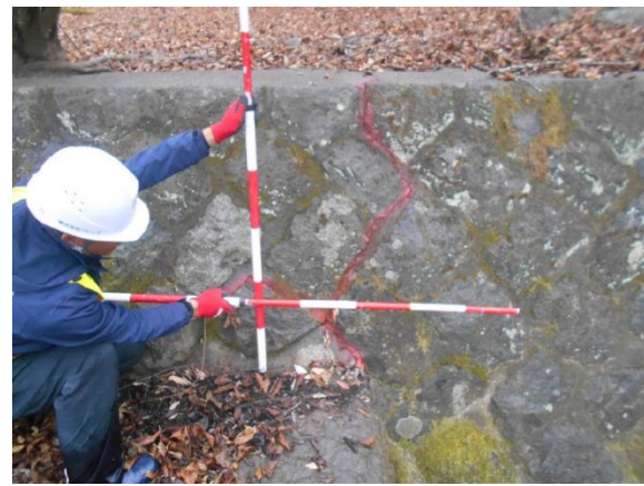
写真-2 変状をマーキングした事例
