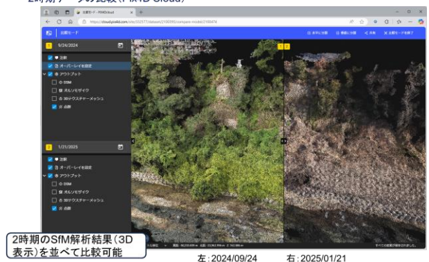
図-5 活用事例 (崖地崩落箇所: 2時期比較)
