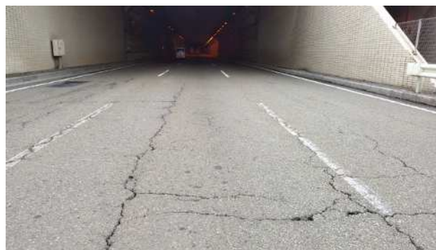
図-5 一般国道X号下り 40kp付近 道路の変状に関する報告の写真 (2024年度) (抜粋)
