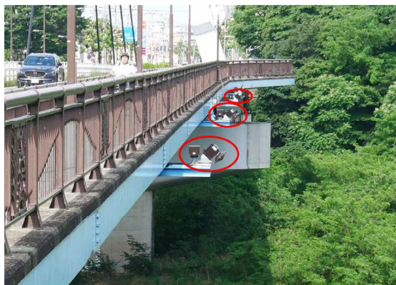
写真4 平成大橋に設置した固定式電波流速計
