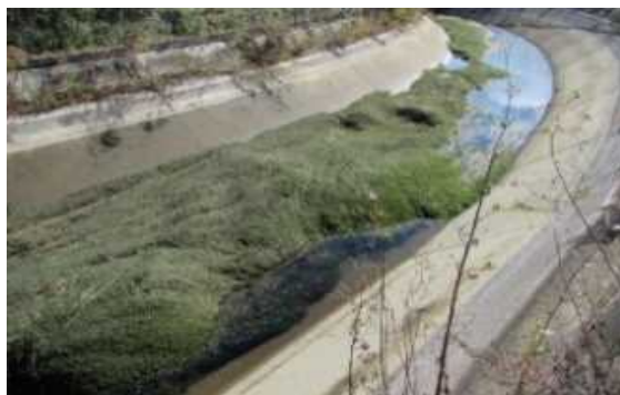
写真-1 土砂堆積状況
