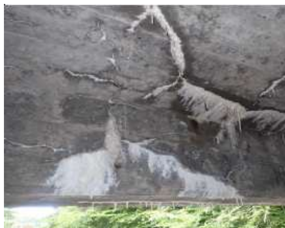
写真-3 主桁のひび割れ、遊離石灰
