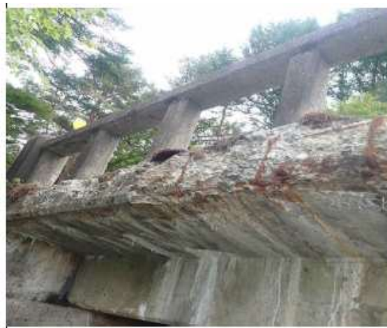
写真-4 剥離・鉄筋露出
