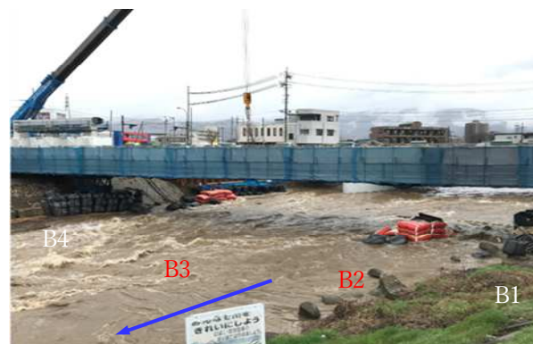
図-6 異常出水時（4月9日）
