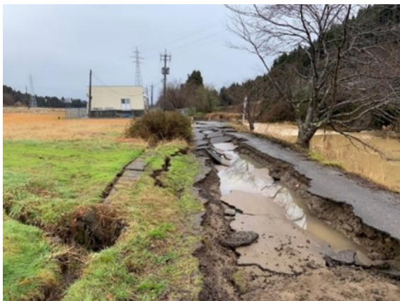
写真-1 基幹施設の被災状況例 (珠洲市内 宝立浄水場・導水ルート)
