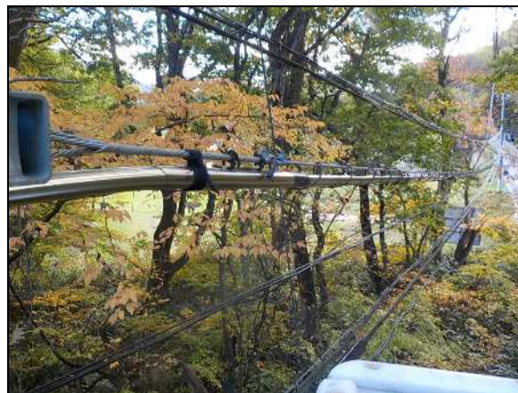
図-3 対策ケーブルカバー
