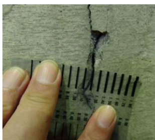
図-5 貫通ひび割れ 1.2mm
