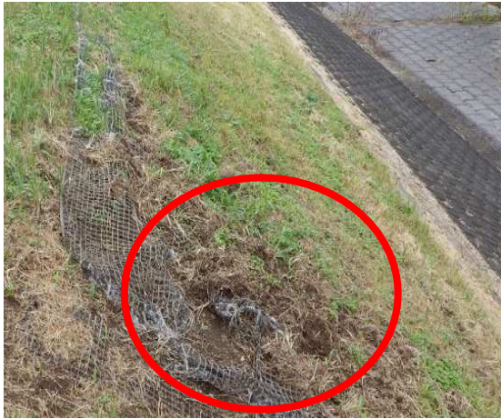
写真5 穴が開いた補強シート
