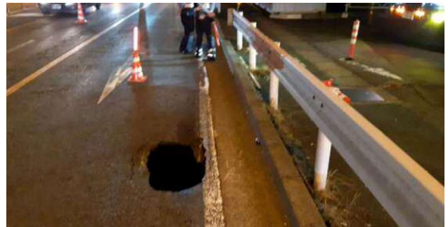
写真-1 2022年6月 上り線第一車線陥没
