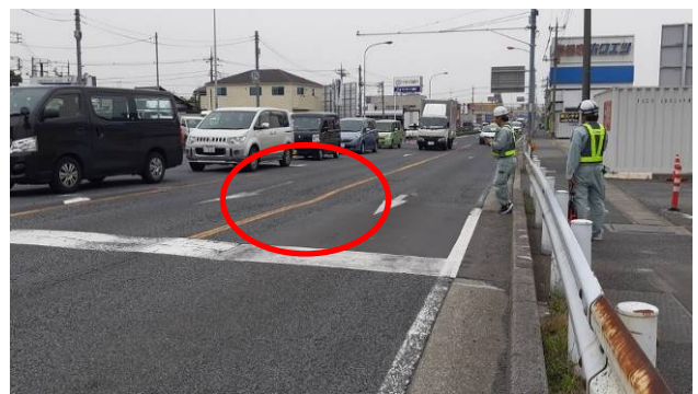
写真-2 2023年6月 上り線第一車線と第二車線の間に沈下
