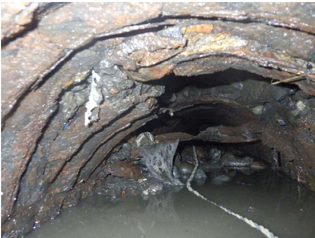
写真-4 老朽化したコルゲート管
