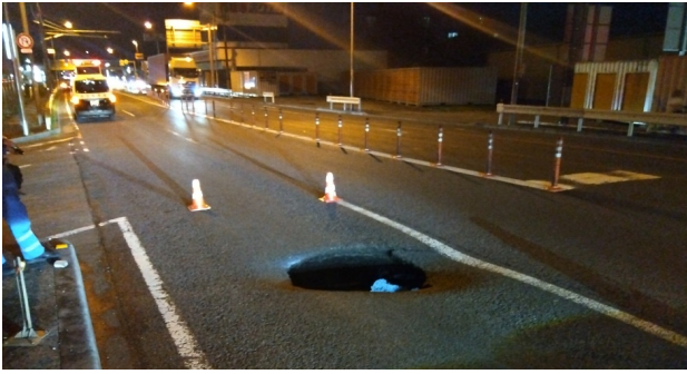
写真-3 2024年7月 下り線第一車線陥没
