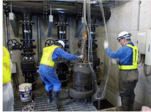
〈排水設備（ポンプ点検）〉
