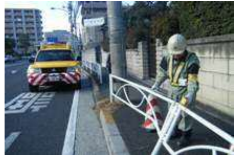
〈防護柵損傷確認〉
