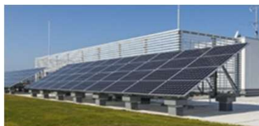
太陽光パネル
