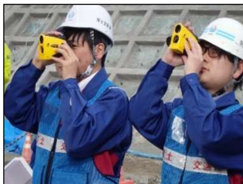
最新測量機器による被害状況調査
