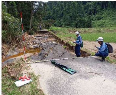
被害状況(道路)の調査 (秋田県由利本荘市)
