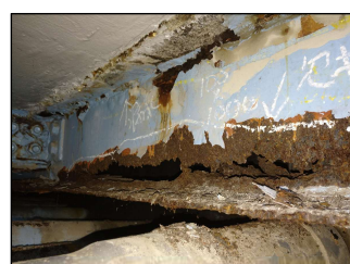
漏水による橋桁の腐食
