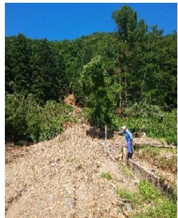
被害状況(砂防)の調査 (秋田県最上郡戸沢村)
