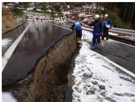
被害状況(道路)の調査 (石川県志賀町)
