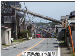
台風等による電柱倒壊状況
