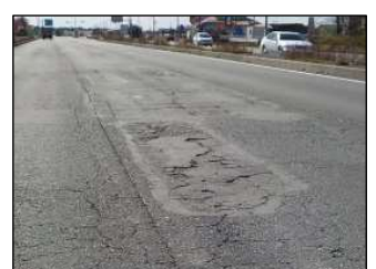
舗装の剥離・ひび割れ
