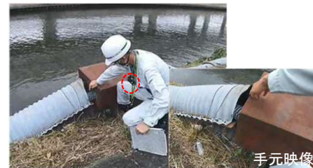
損傷状況の確認
