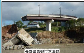
河川沿いの橋台崩落
