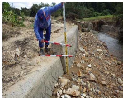
被害状況(河川)の調査 (石川県珠洲市)
