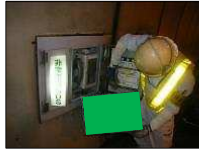
〈トンネル非常警報施設点検〉
