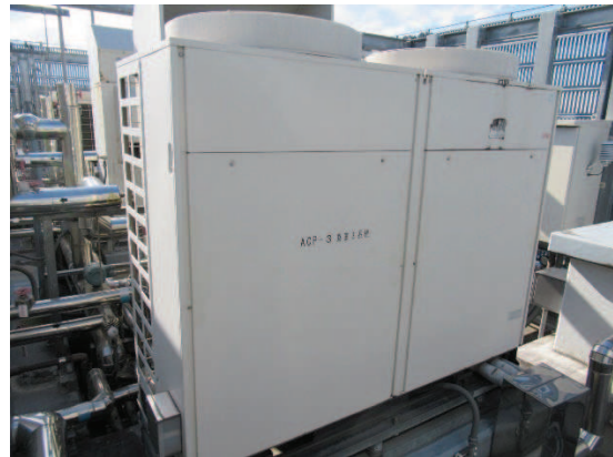
南寮 屋上室外機
