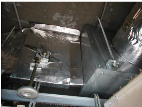
南寮 寮室室内機
