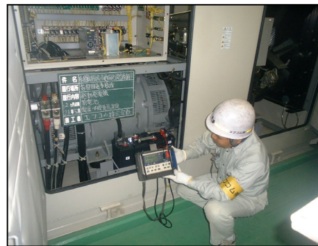
〈発電設備（蓄電池等点検）〉
