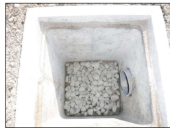
雨水貯留浸透枡整備事例(昭和町)
