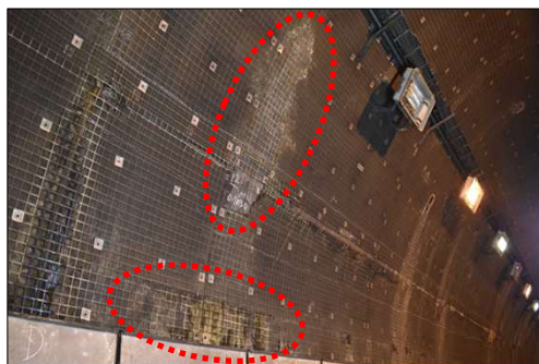
老朽化状況(現トンネル)
