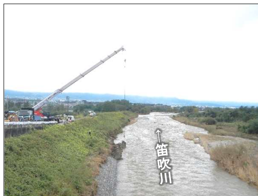
応急復旧状況(R1年洪水)
