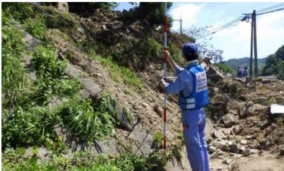
被災状況調査
