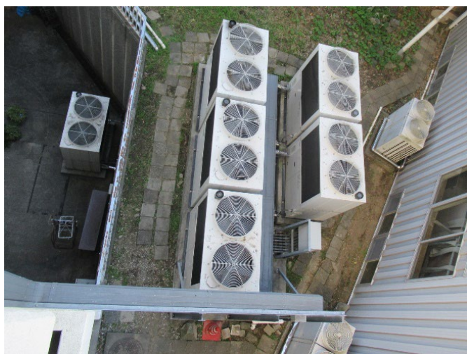
本館 GHP 屋外機置き場(上から撮影)
