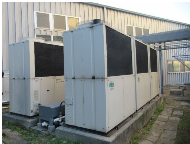
本館 GHP 屋外機置き場
