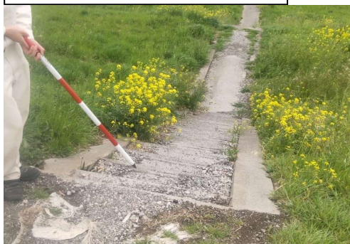
砂利が堆積し、転倒の危険
