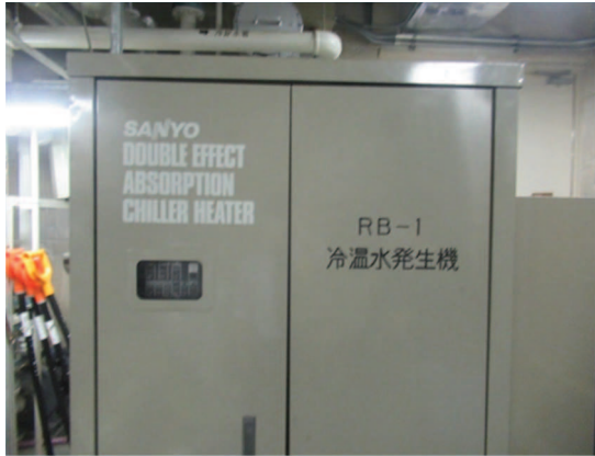
①吸収冷温水機
