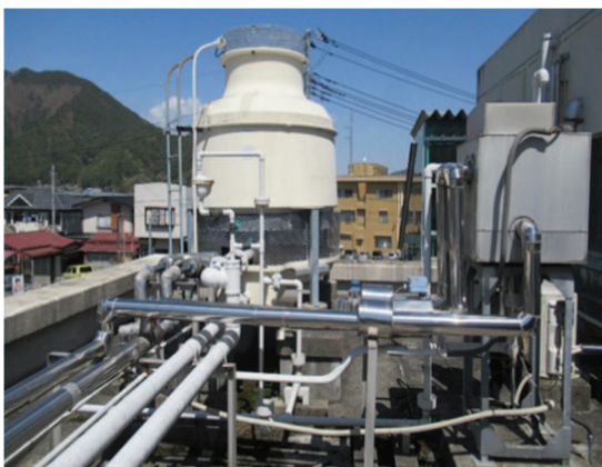
⑤冷却塔及び膨張タンク
