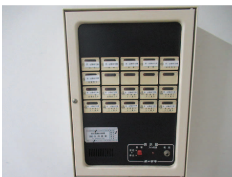
図5 第2試験研究棟（副受信機）
