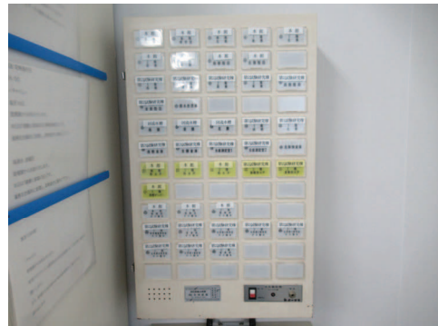
図2 事務庁舎棟（副受信機）
