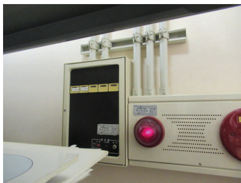
図4 第1試験研究棟（副受信機）
