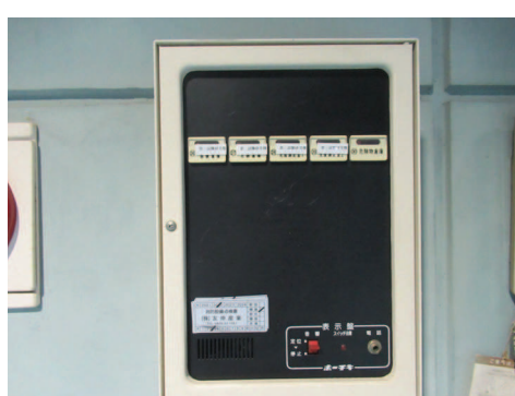
図6 第3試験研究棟（副受信機）
