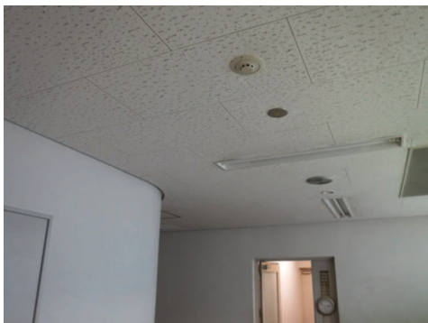
図3 事務庁舎棟（感知器）
