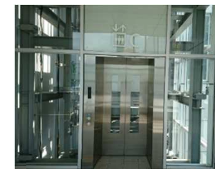
エレベーター
