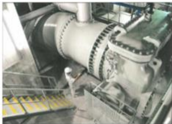
雨水ポンプの整備
