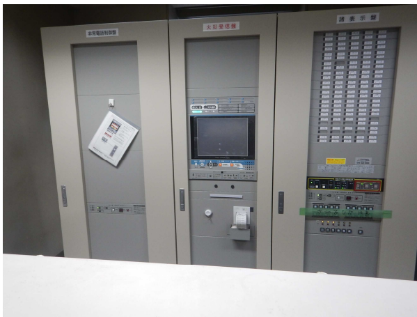
総合操作設備
