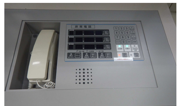
防災監視卓・非常電話装置
