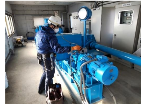
開閉装置の点検
