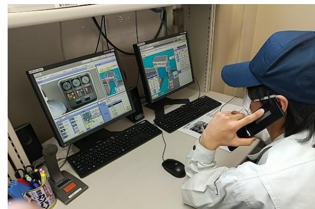
水門等の施設の遠隔操作
