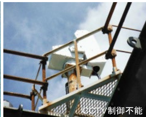
旧観測施設架台老朽化状況
