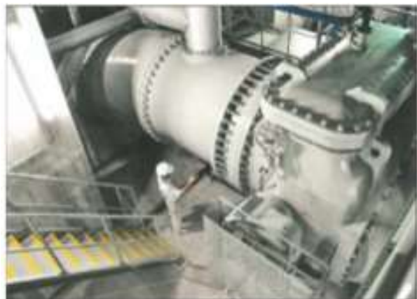
雨水ポンプの整備
