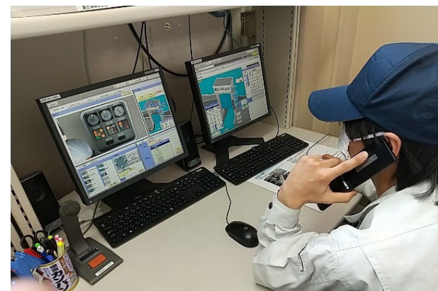
水門等の施設の遠隔操作
