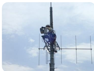
監視カメラ（CCTV）
