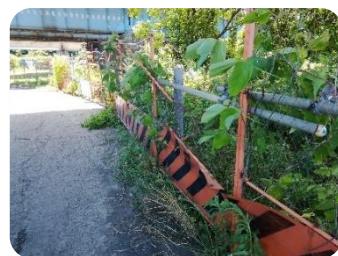
フェンスの破損を確認
