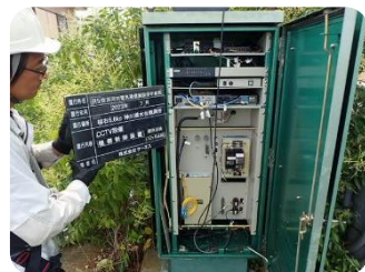
テレメータ設置
