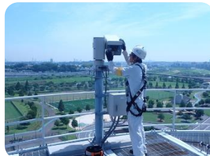
監視カメラ（CCTV）
