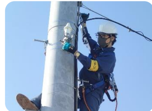
テレメータ設置
