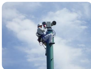
監視カメラ（CCTV）
