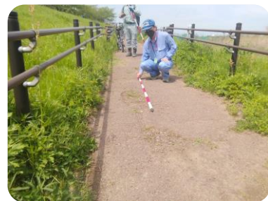
舗装の陥没を確認
