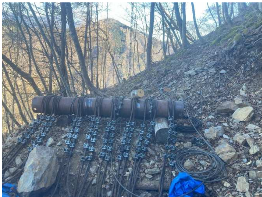
索道上部アンカー
