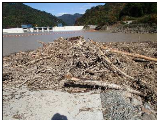
流木補足状況 (令和元年東日本台風後)
