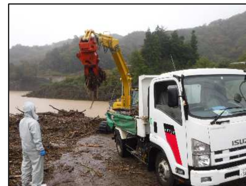
流木回収状況 (令和元年東日本台風後)
