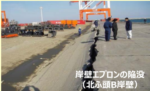
○常陸那珂港区の被災状況(東日本大震災)
