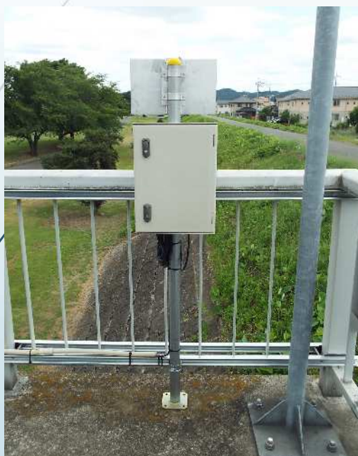
通信制御装置
