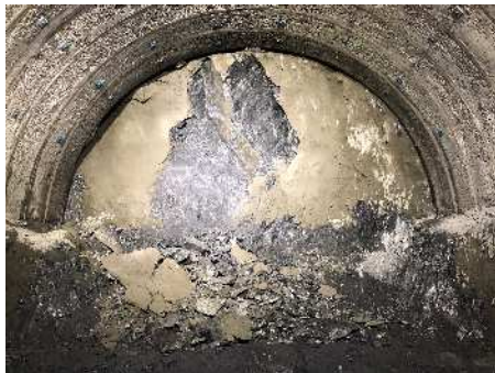
〔新小仏トンネル(仮称)〕写真:2024年8月 切羽崩落状況 掘削進捗:約1,000m(2024.1)→約1,500m/約2,300m(2024.10)
