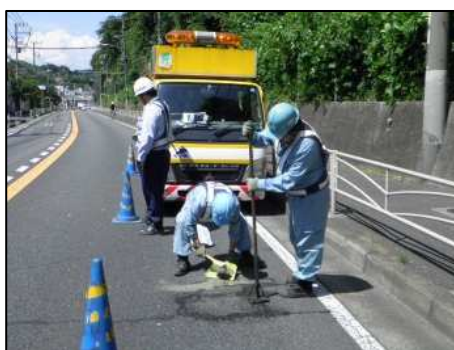
〈路面補修：ポットホール〉
