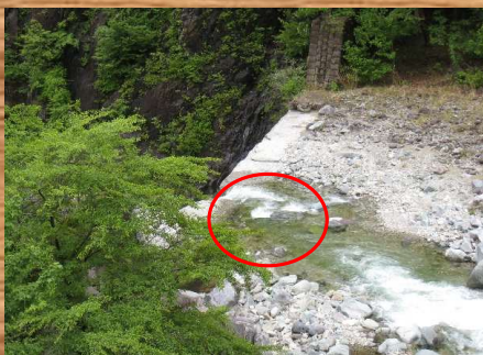
水通しの摩耗が進行している (松木川二号砂防堰堤)
