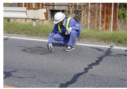
〈路面段差確認〉
