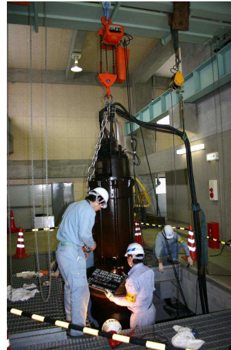
〈排水設備点検〉
