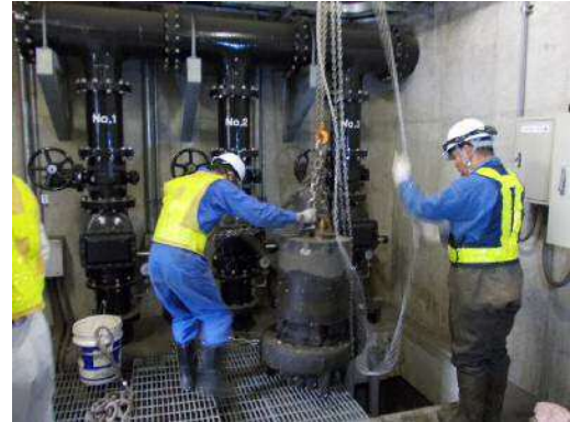
〈排水設備（ポンプ点検）〉
