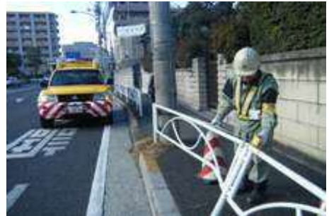
〈防護柵損傷確認〉
