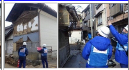
調査箇所：石川県志賀町 調査箇所：石川県穴水町
