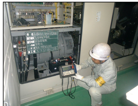
〈発電設備（蓄電池等点検）〉
