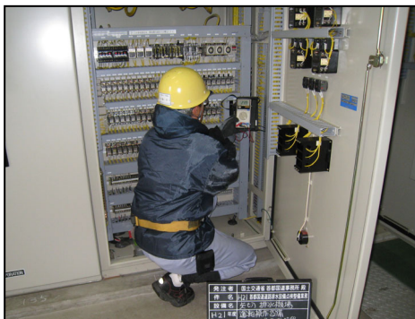
〈排水設備（電源装置点検）〉
