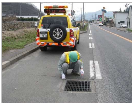
〈路面段差確認〉
