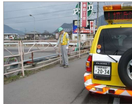
〈防護柵損傷確認〉
