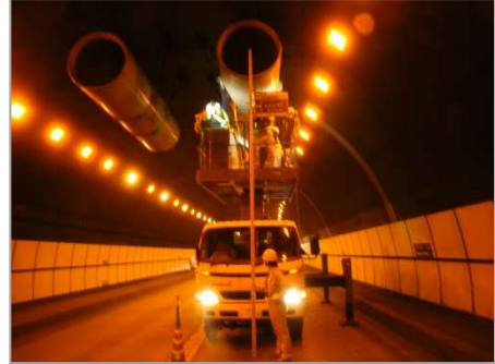
〈トンネル換気設備〉
