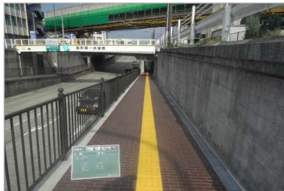
〈歩道融雪設備整備〉
