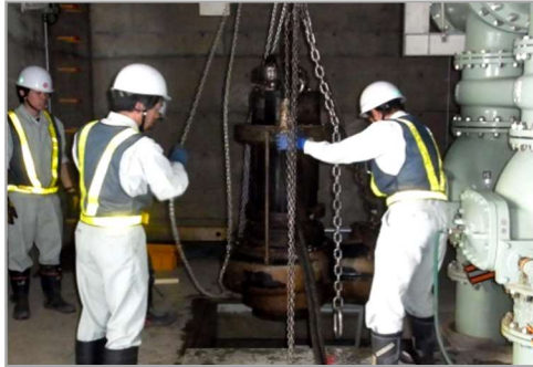
〈道路排水設備〉
